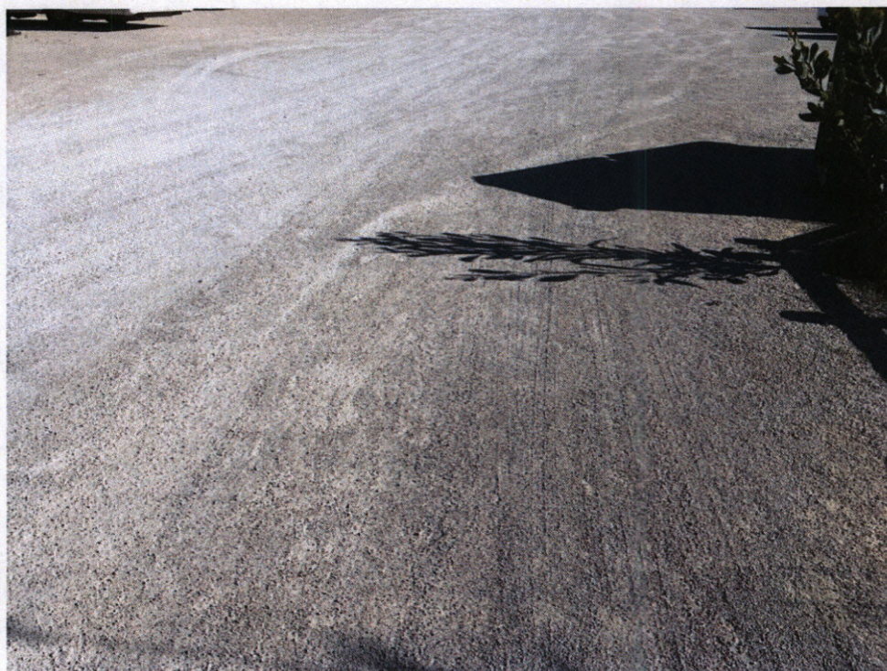
Fotografia 20 – Condições do pavimento à entrada do parque de estacionamento
