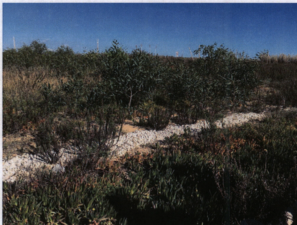
Fotografia 5 – Bacia de infiltração
