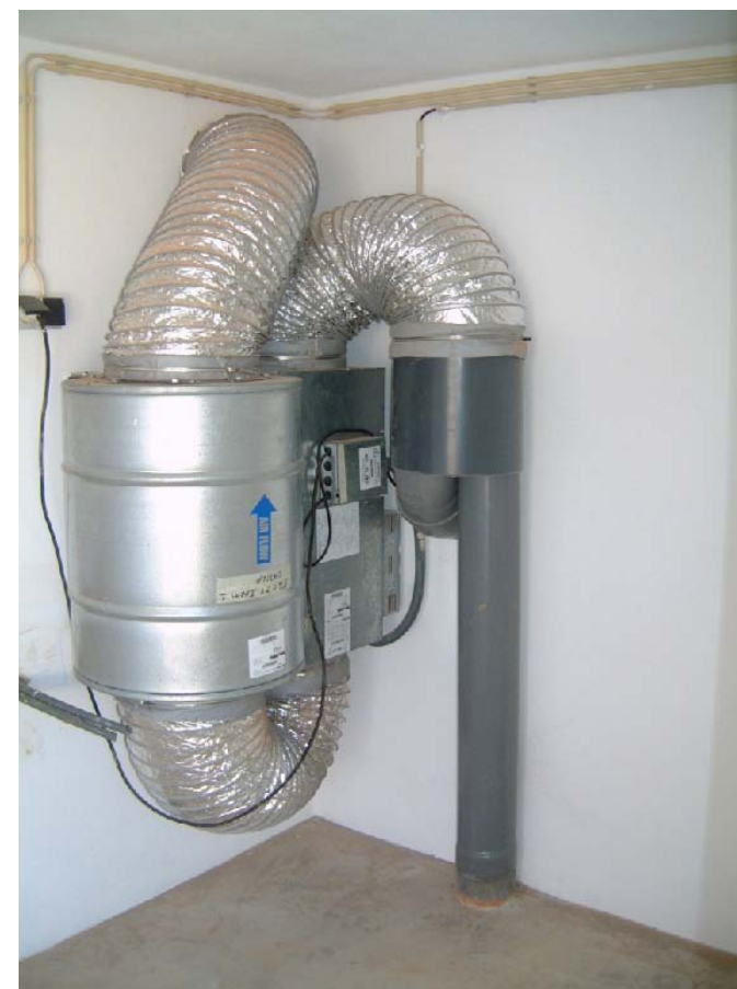
Ventoinha daCoolhouse 0.17Kw e atenuador Tubos subterrâneos e conduta de fornecimento de ar
