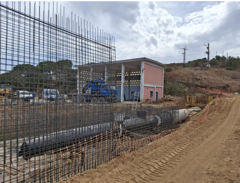
Estação de Filtragem e Estação Elevatória
