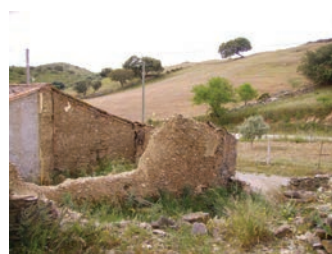
Edifício de taipa parcialmente destruído pela acção dos agentes atmosféricos. Silgado, Alcoutim. fotografia Marta Almeida
