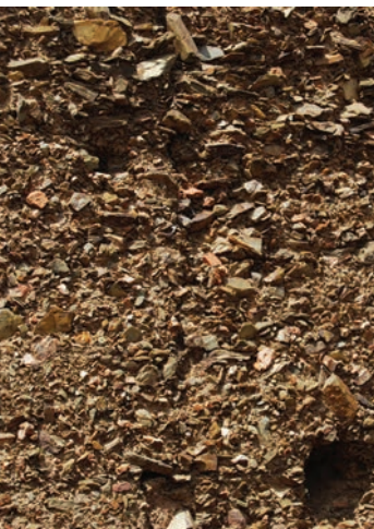
Edifício de taipa em processo de degradação devido à queda da cobertura. Alcarias Pedro Guerreiro, Tavira.
