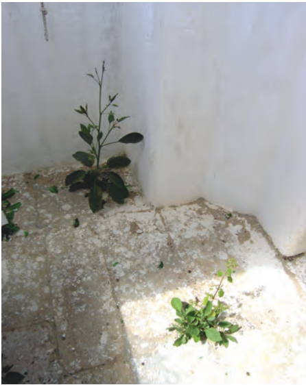
vegetação no pavimento da torre f S M
